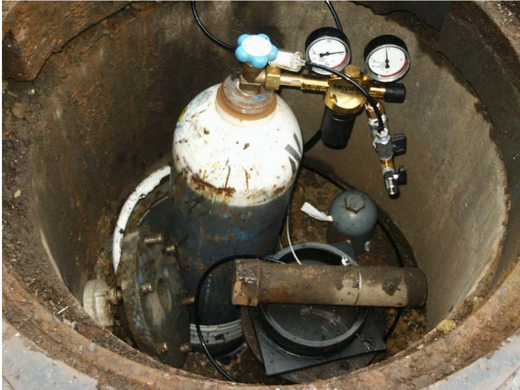
Abb. 2: Unterflur-Installation von Sauerstoffflasche (86 cm) mit Druckminderer in einer Brunnenstube direkt neben dem iSOC®-Brunnen
